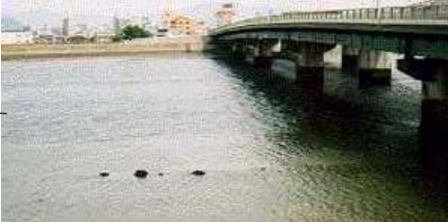
庚午橋上流の杭: 庚午橋上流約20mの旧橋脚の杭。大潮干潮時には、危険。要注意。
